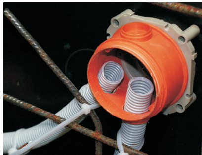
Корпус KBV и подведенные в него трубы.
